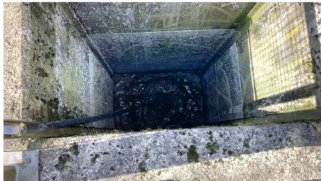
Abb. 5: Das ist jetzt vorbei – Fettschacht vor der Beimpfung
