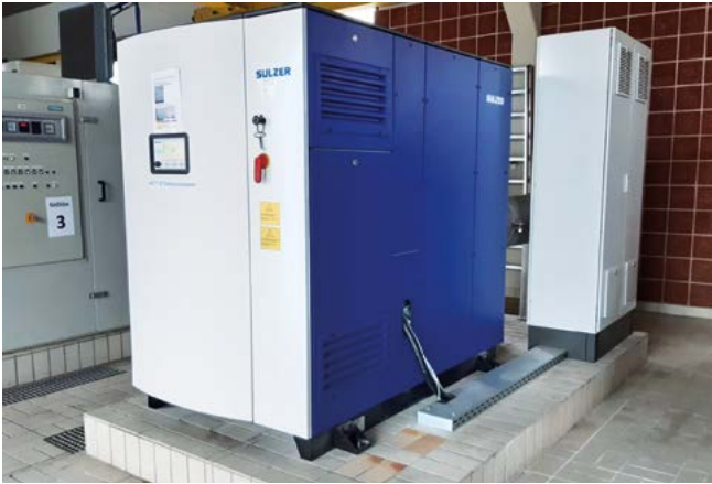
Abb. 6: Neuer Turboverdichter für Wechselzonen
