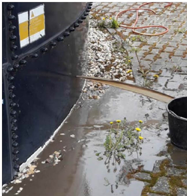
Abb. 6: Havarie am Schlammstapelbehälter
