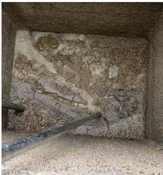
Abb. 1: Fettschacht vor der Beimpfung
