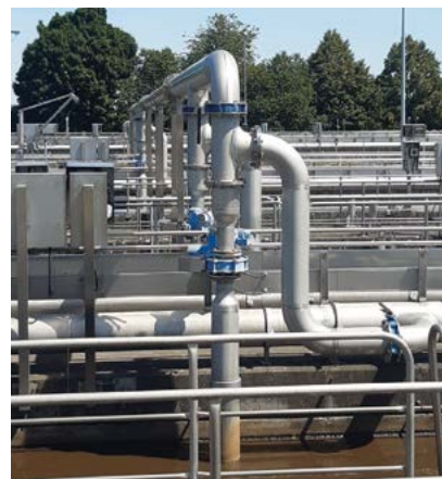
Abb. 5: Separate Druckluftleitung für Wechselzonen
