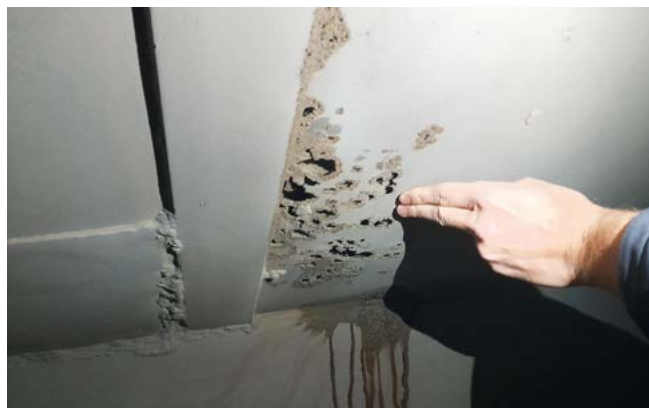
Abb. 2: Durchrostung im Bereich der Schlammfächer
