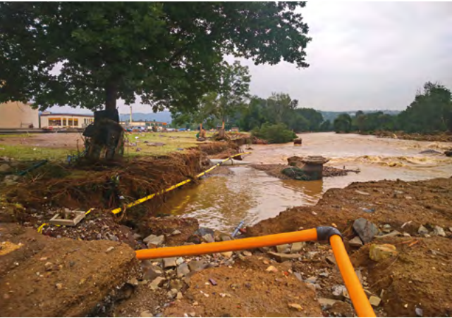
Abb. 11: Freigespülte Gasleitung zur Versorgung der Kläranlage; Kanalschächte der Ahrquerung stehen in der Ahr (Foto: Marco Laux)
