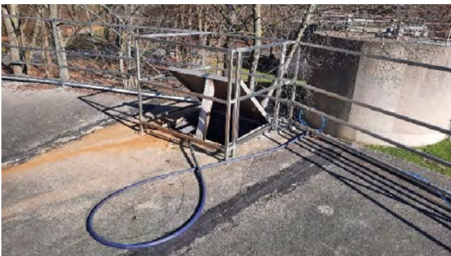
Abb. 5: Dosierstelle im Schlamm Speicher (Fotos: Stadtentwässerung Langenhagen)
