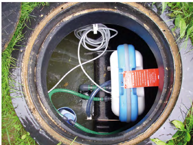
Abb. 4: Stromführende Bauteile im Abwasserbehälter
