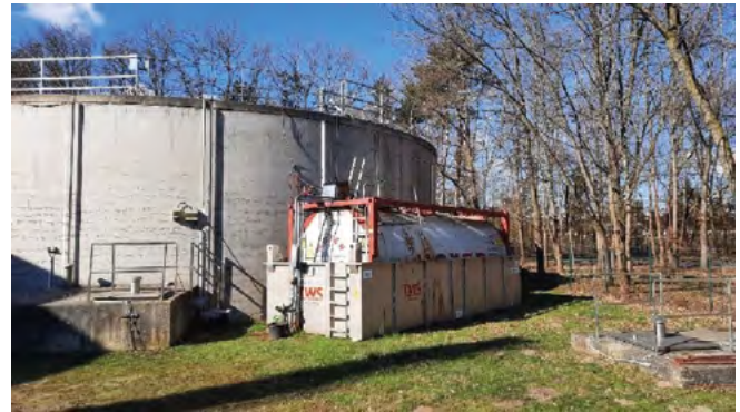
Abb. 6: Miettank einschließlich Auffangwanne für die Lagerung von Eisenchlorid-Lösung (Foto: Stadtentwässerung Langenhagen)
