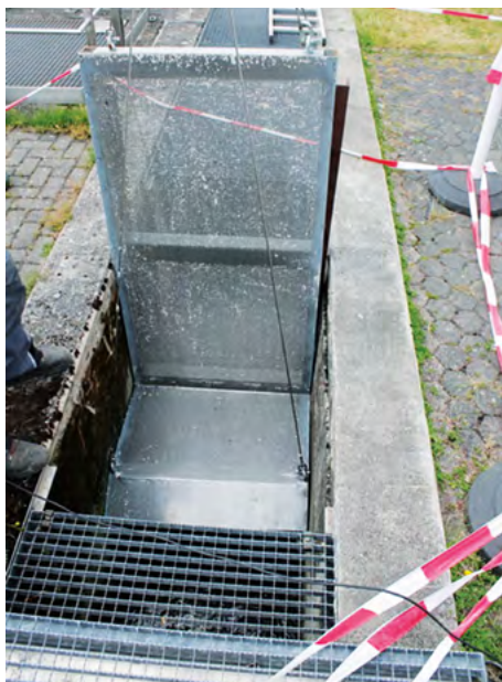
Abb. 1: Rechen im unbelegten Zustand
