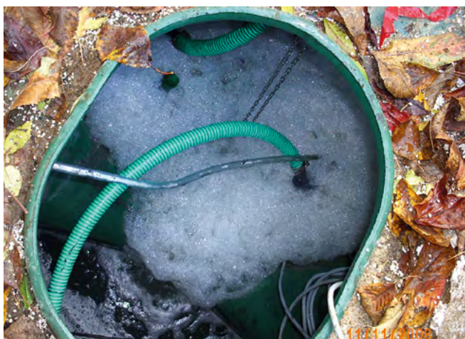
Abb. 6: Schaumbildung durch Einleitung von Reinigungsmitteln
