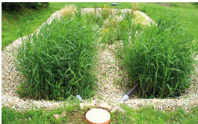
Abb. 1: Pflanzenkläranlage mit üppigem Bewuchs
