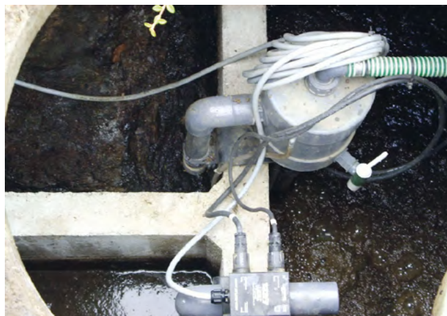
Abb. 3: Belebungsanlage mit Druckluftbelüftung
