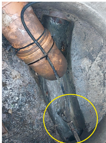
Abb. 2: Die eingebaute Sonde mit dem selbstreinigenden Kippmechanismus
