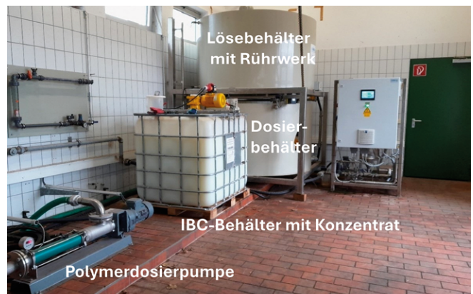
Abb. 3: Die Polymeraufbereitung mit Dosierpumpe
