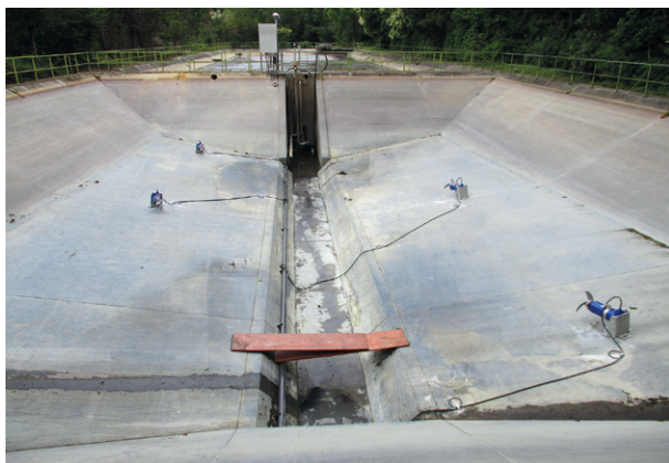
Abb. 5: Das leere Stapelbecken mit den am Boden befestigten Rührwerken
