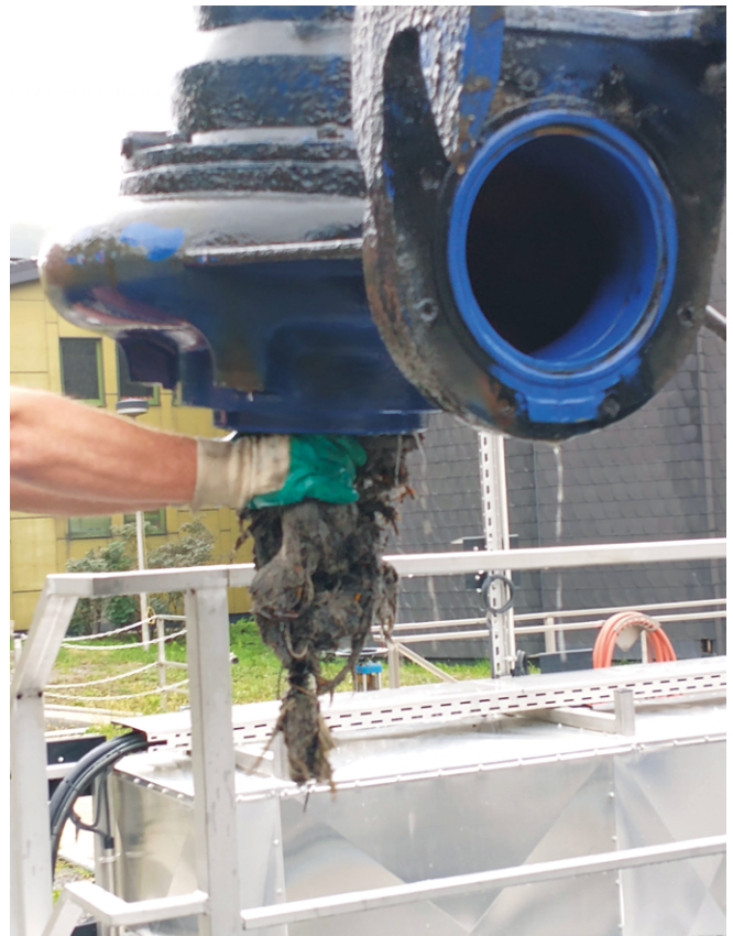
Abb. 6: Verstopfte Beschickungspumpe aufgrund von Rechengut-eintrag
