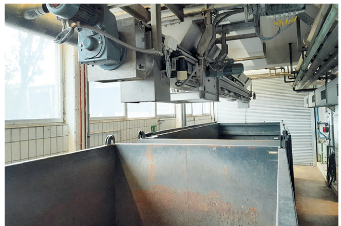
Abb. 4: Der Schlammverladeförderer und die Container im EG
