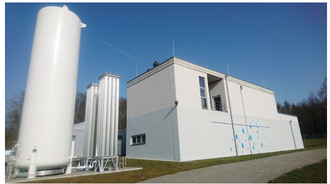
Abb. 2: Sauerstofftank und Ozonreaktorgebäude
