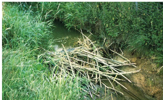
Abb. 6: Ein (noch) kleiner Biberdamm im Gewässer kann den Ablauf behindern.
