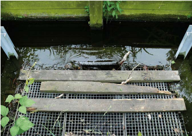
Abb. 7: Schwemmgut am Rechen des Ablaufs
