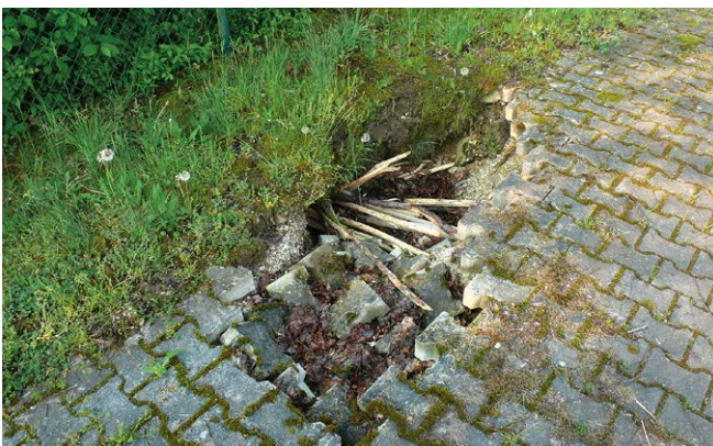
Abb. 8: Einbruch an einer unterminierten Zufahrt zu einer Kläranlage
