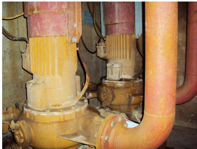
Abb. 1: Rohwasserpumpen und Leitungen im Bestand
