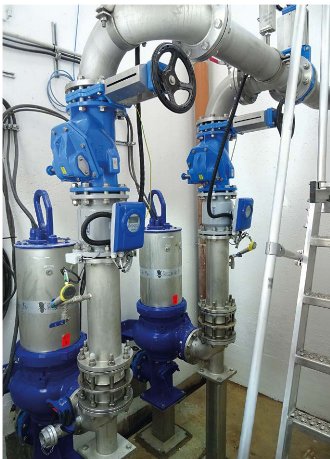
Abb. 4: Neue Rohwasserpumpen und Installation
