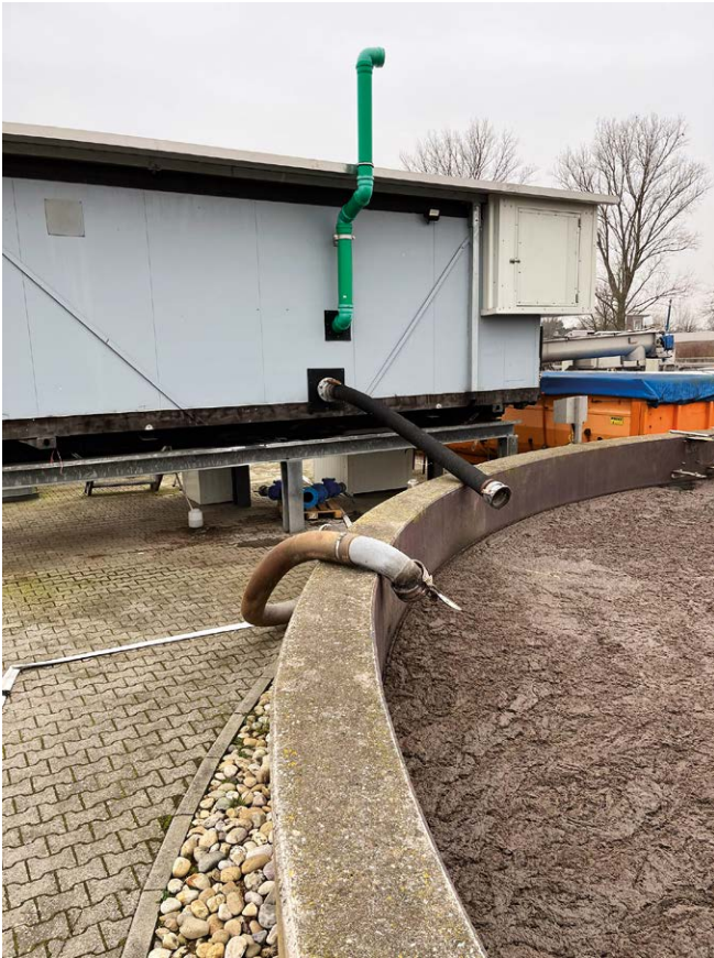
Abb. 2: Entlüftung der Schlammwässerung – der grüne Kamin
