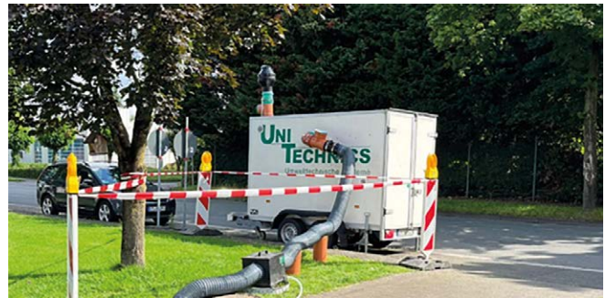
Abb. 4: Die mobile Abluftbehandlungsanlage
