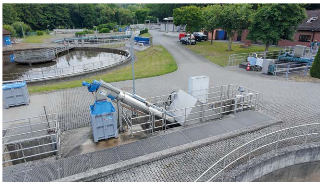
Abb. 2: Die im Freien im Gerinne installierte Feinsiebanlage
