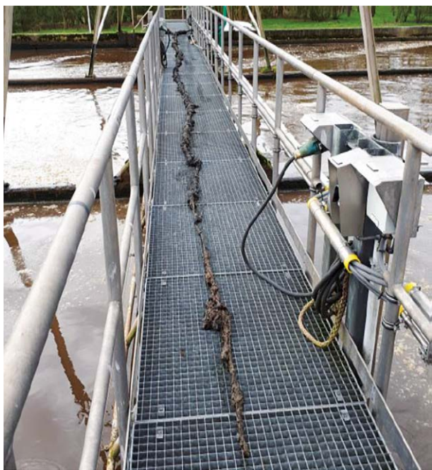
Abb. 1a und 1b.: Feuchttücher umwickeln einen Rührer. Der Feuchttuchzopf auf der Kläranlage Kaatsheuvel ist viele Meter lang (Quelle: WSBD; wet wipes in the wastewater and environment; Projectnummer 51015895; Datum 07-08-2024)
