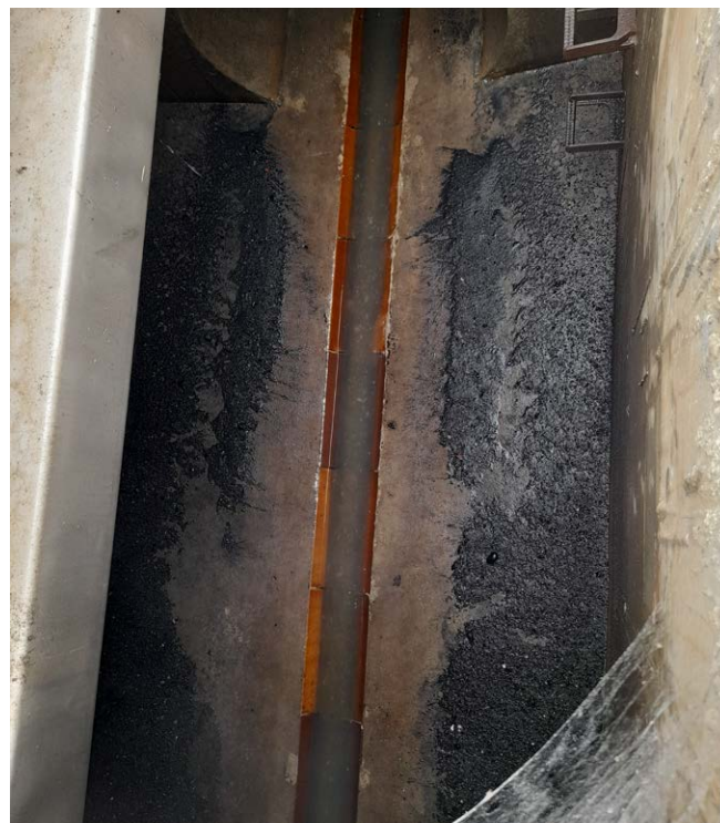
Abb. 4: Gerinne vom Entlastungsbauwerk vor der Kläranlage mit Rußpartikel und Brandgut
