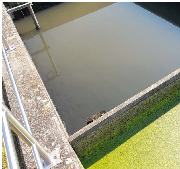
Abb. 7: Die eingehängte Tauchwand verhindert Schlimmeres.
