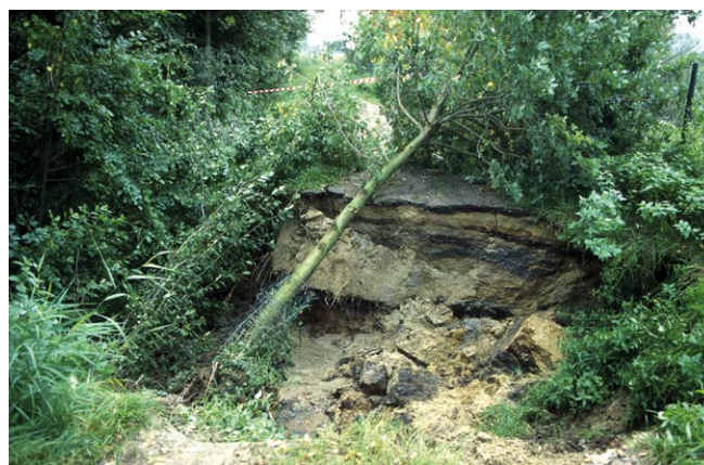
Abb. 5: Durch eine Biberröhre und nachfolgende Ausspülung gebrochener Damm an einer Kläranlage
