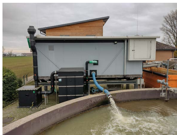
Abb. 6: Die neu errichtete stationäre Abluftbehandlungsanlage für die Schlammentwässerung
